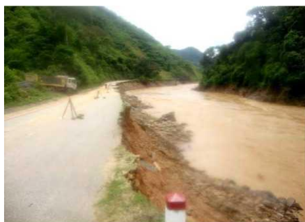
nh 18. Xói lở bờ sông gây sạt lở nghiêm trọng Quốc lộ đoạn thuộc địa phận bản Bà, Hữu Kiệt, huyện Kỳ Sơn.
