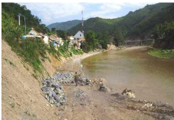
nh 16. Xói lở bờ sông đoạn thuộc địa phận thị trấn Mường Xén, huyện Kỳ Sơn.
